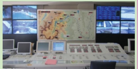
現在のダムコン（操作室）
