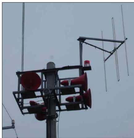
【放流警報】：放流開始前にサイレンの疑似音（ホーンホーン…という音）を鳴らし、赤色回転灯を点灯させます。
