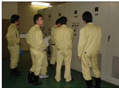
【操作訓練】：自家用の予備発電機への切替方法を講習中。
