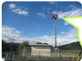
放流警報設備の全景
