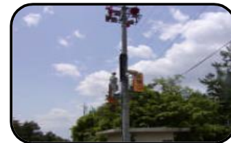
警報装置の点検
