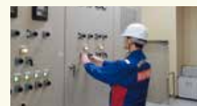
↑受変電設備の点検
