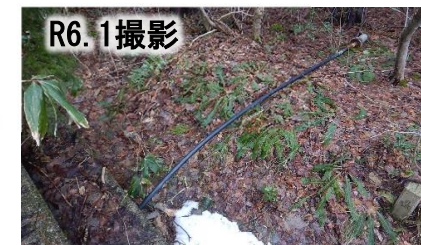
地震による既設アンカー破断
