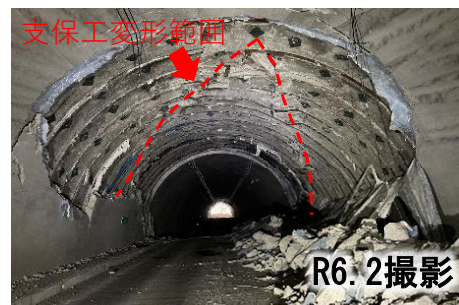
地震によるトンネル覆工崩落
