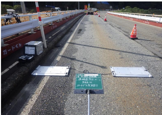
【ポータブル型車両重量計設置状況】
