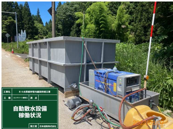
散水装置（貯水タンク・エンジンポンプ）
