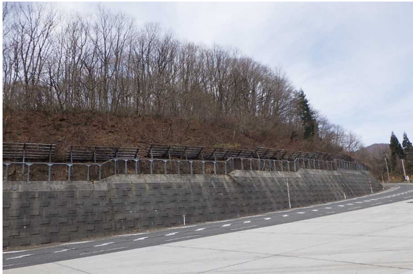
写真① 着手前:擁壁天端には15m毎に段差が設けられている。
