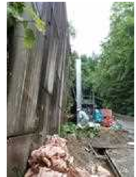
写真 壁面の傾斜の例
