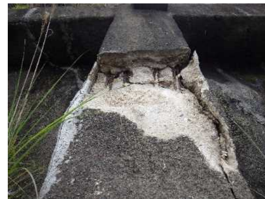
法枠工の老朽化損傷
