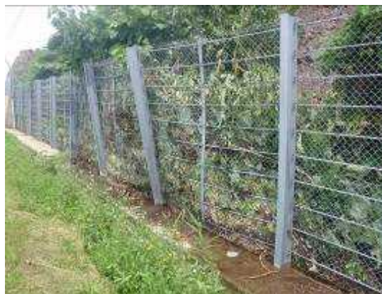
写真 落石防護柵の傾動の例
