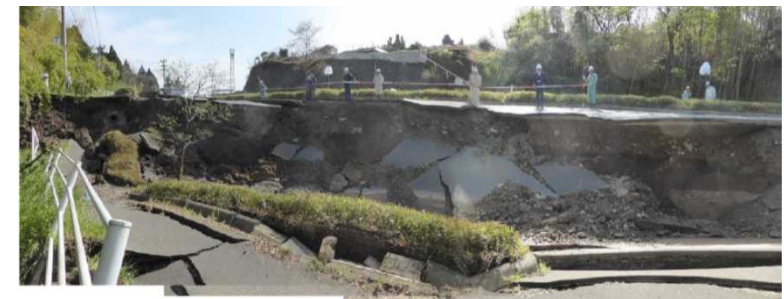
路面陥没地付近の状況（4月15日）
