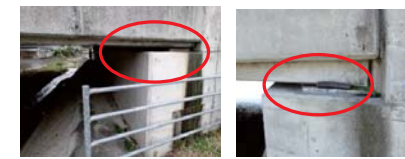
支承交換の作業空間なし
