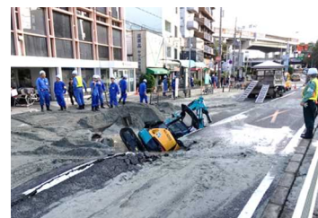
埋設管の老朽化に伴う道路陥没
