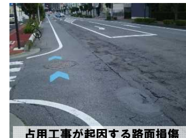
占用工事が起因する路面損傷
