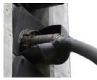
ケーブル損傷例
