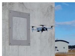
ドローンによる損傷把握
