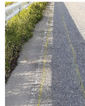
区画線の摩耗
