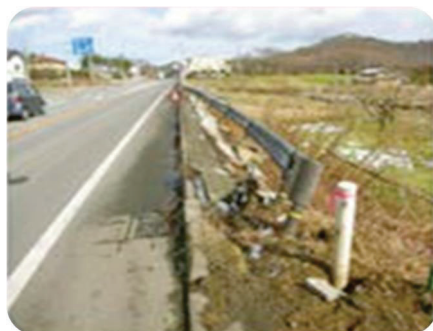
ガードレール・ 標識等の損傷
