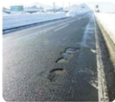
路面の穴ぼこ・ 段差
