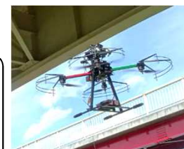
ドローンによる損傷把握
