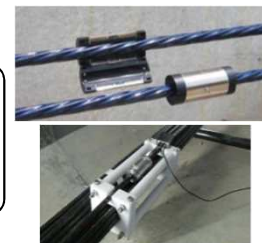
センサーによる橋梁ケーブル張力のモニタリング
