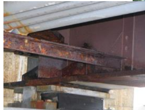
橋面排水の影響による腐食
