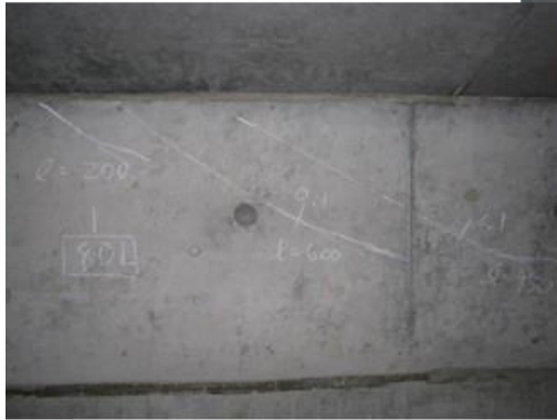
箱桁ウェブ面のひびわれ
