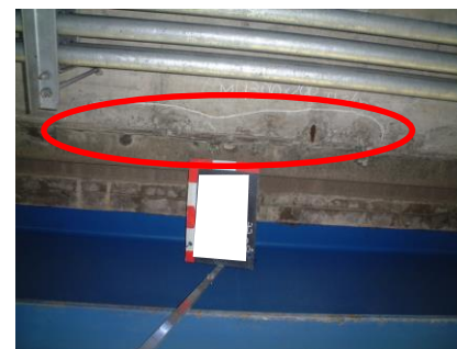
主桁の剥離・鉄筋露出
