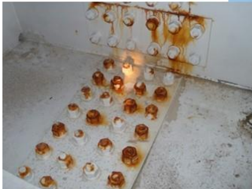
箱桁内のボルト部の腐食
