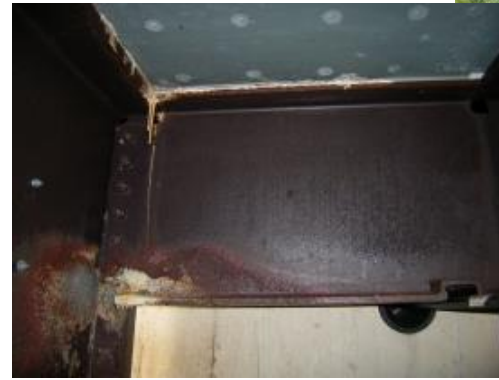
床版からの遊離石灰の析出
