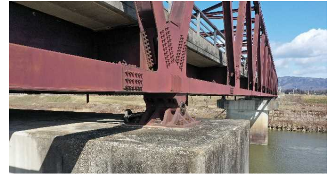
P2支承（固定）：ピンの脱落
