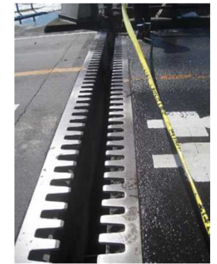
A1橋台上の伸縮装置の開き 橋軸方向：約40cm 橋軸直角方向：約20cm
