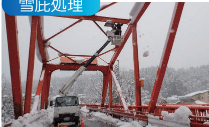
落雪の危険がある雪のかたまりを取り除きます。
