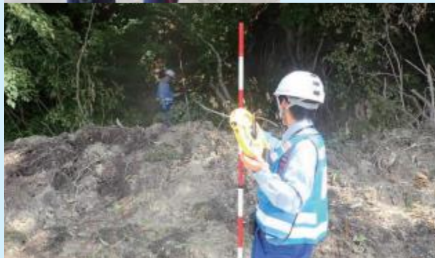
被災状況調査の様子(8/4)
