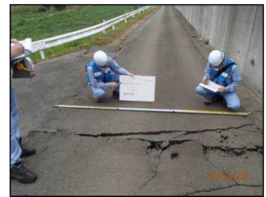
直轄国道被災状況調査
