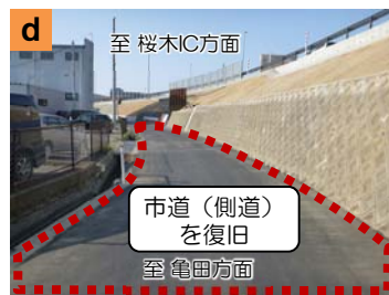
亀田方面→桜木方面の仮設ランプを撤去し、市道（側道）を復旧しました。
