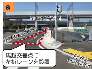
馬越交差点や県道新潟新津線で道路の改良を行いました。
