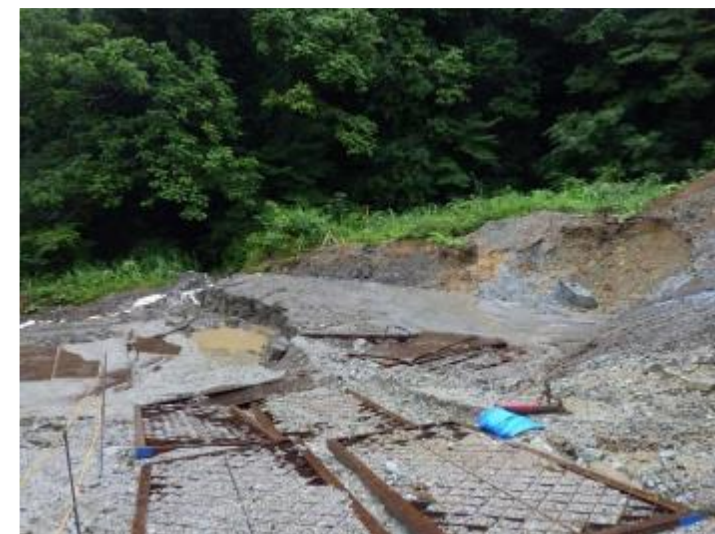
地すべり発生状況(R7.9)
