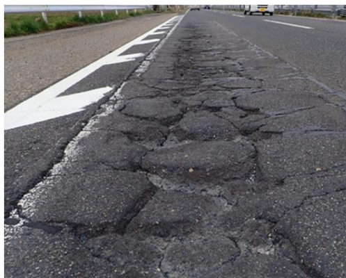
舗装のひび割れ
