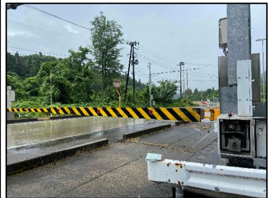
遮断機を降下完了した状況 (津川除雪ST)
