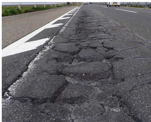
舗装のひび割れ
