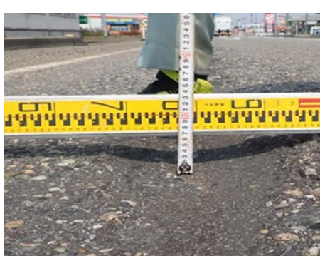
舗装のわだち掘れ
