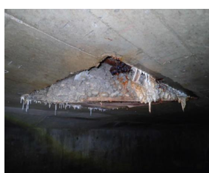
橋の裏面の損傷
