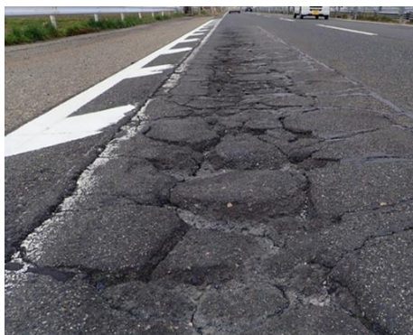
舗装のひび割れ
