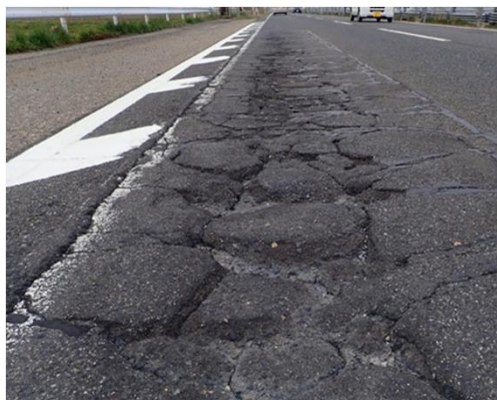
舗装のひび割れ
