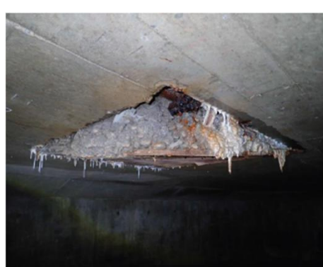
橋の裏面の損傷
