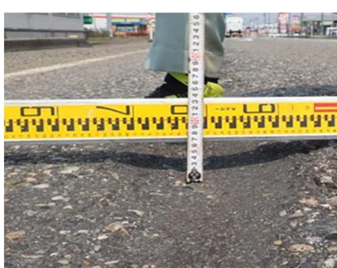
舗装のわだち掘れ
