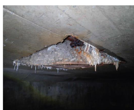
橋の裏面の損傷
