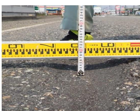
舗装のわだち掘れ
