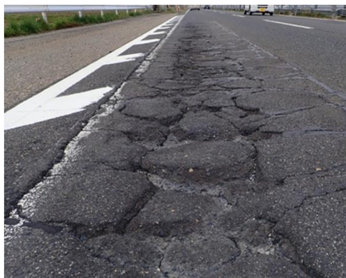
舗装のひび割れ
