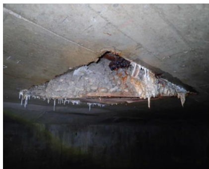
橋の裏面の損傷
