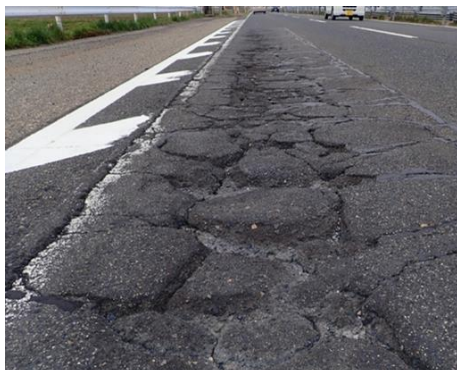
舗装のひび割れ
