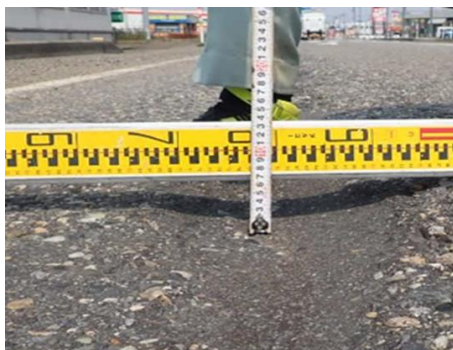
舗装のわだち掘れ
