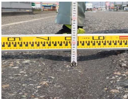
舗装のわだち掘れ
