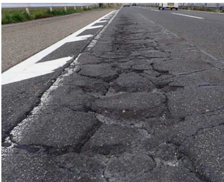
舗装のひび割れ
