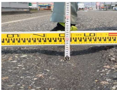
舗装のわだち掘れ
