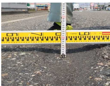
舗装のわだち掘れ
