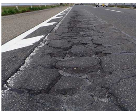
舗装のひび割れ
