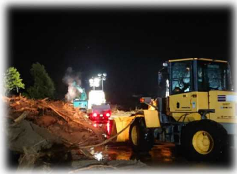
むらかみし、はなだて 国道113号村上市花立付近の被災状況 (令和4年8月撮影)
