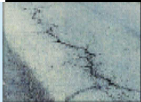
舗装のひび割れ
