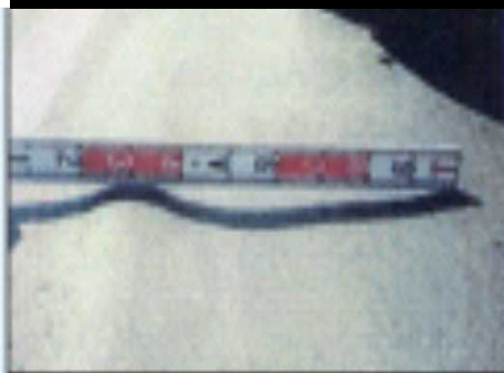
舗装のわだち掘れ
