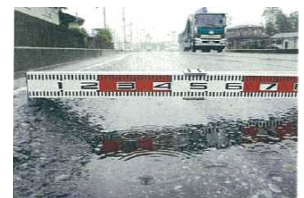
舗装のわだち掘れ
