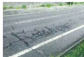
舗装のひび割れ
