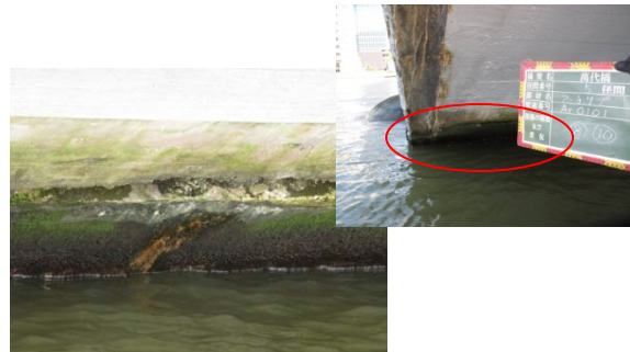
写真 アーチ下面の軽微な損傷
