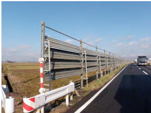
現在の防雪柵収納前の状況
