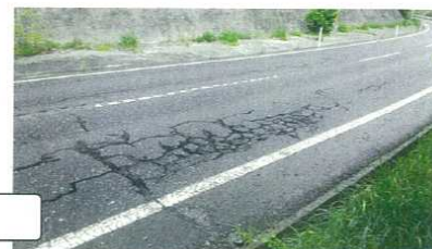
舗装のひび割れ
