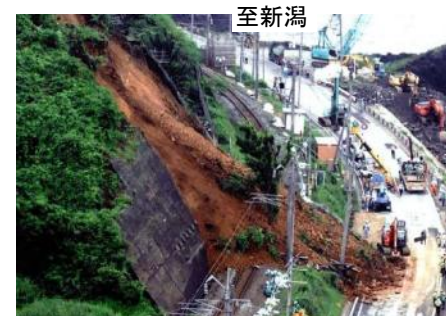
法面崩壊(鶴岡市小岩川地区)
