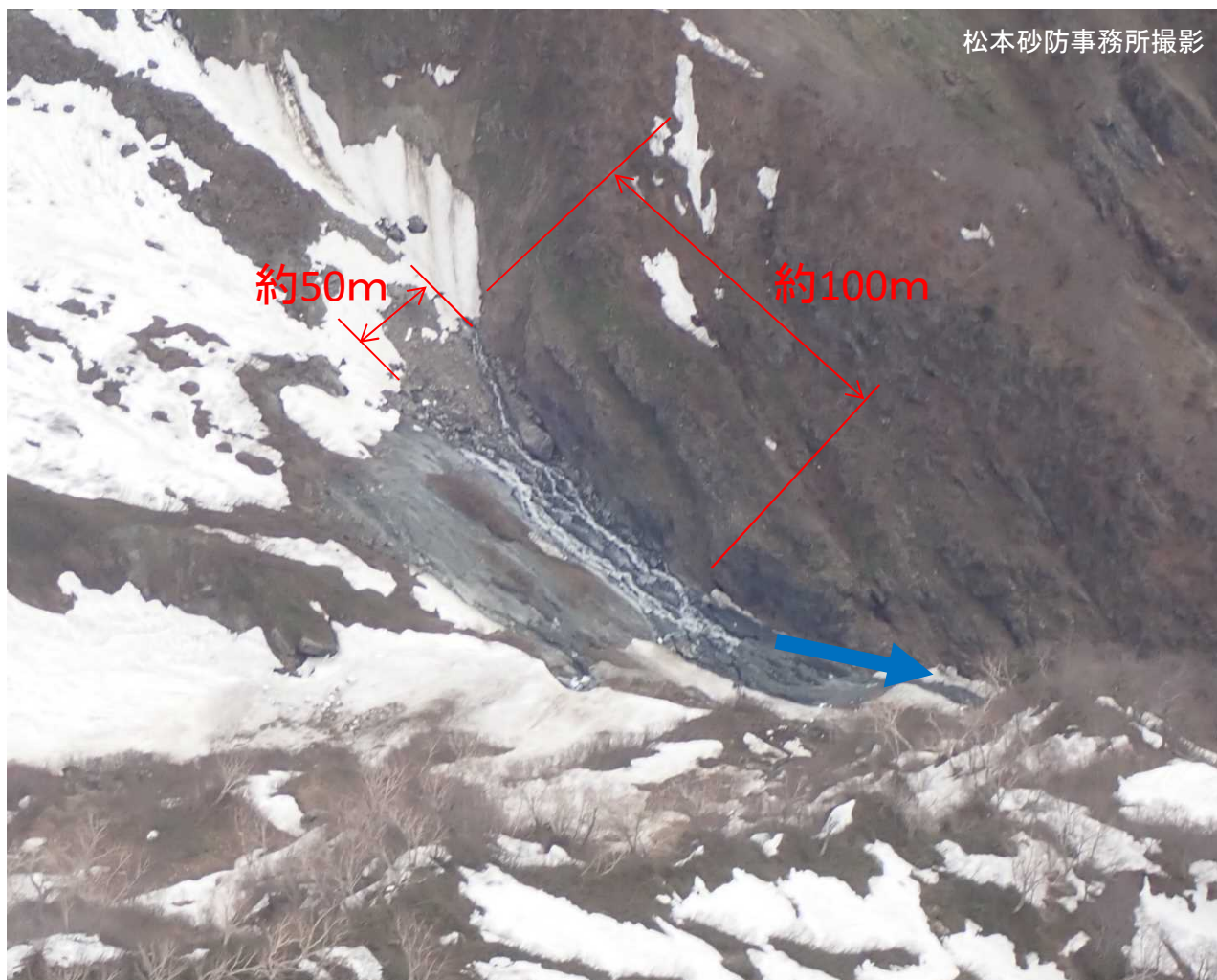
写真-1 湯ノ入沢源頭部(崩壊地の状況)
