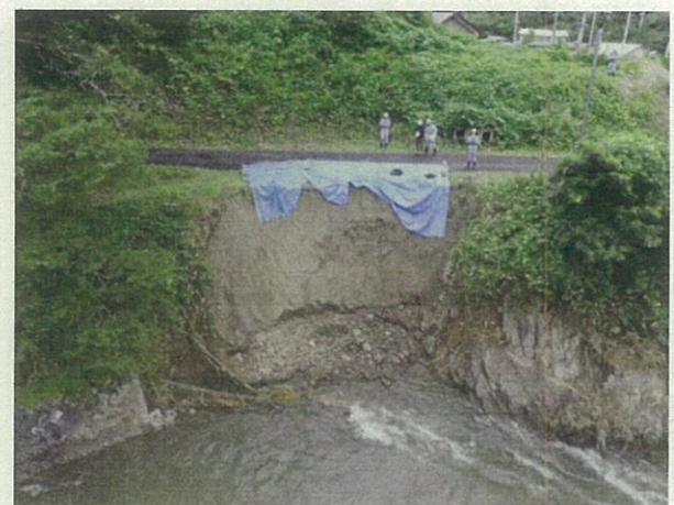
▲ 岩手県普代村（普代川）の被災状況 （北陸地整TEC-FORCE）
