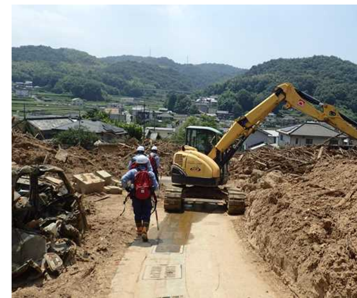
土砂災害現場の状況確認[福山市神村町]
