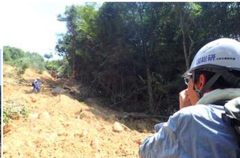
崩壊斜面状況の確認[福山市神村町]
