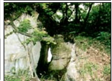
◆H6年頃 そでのきわ 袖ノ沢地区の地割れ
