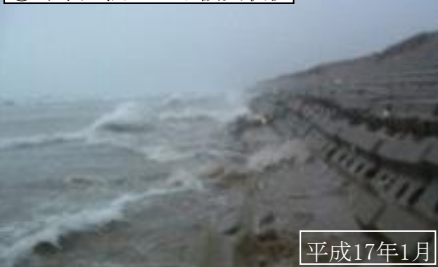
② 冬季風浪による被災状況
