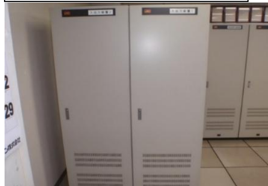
ダム管理用制御処理設備(小屋ダム)
