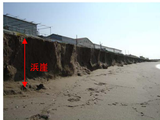
きんえいちょう 金衛町工区被災状況(平成18年9月)
