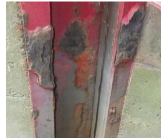
腐食したゲート設備の修繕
