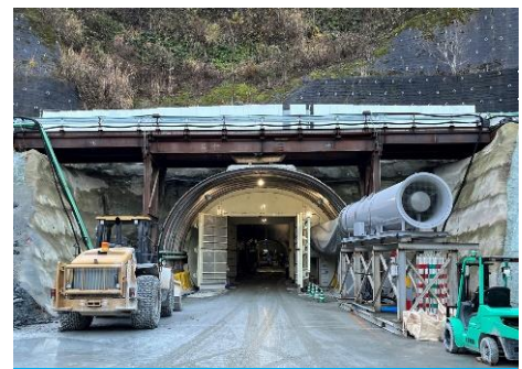
利賀トンネル起点側 (南砺市利賀村長崎地区)の施工状況 (R5.12撮影)
