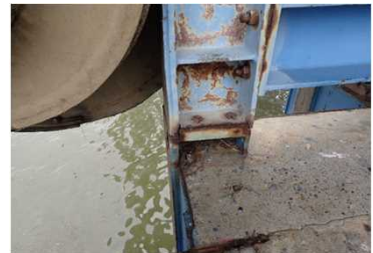
腐食したゲート設備の修繕
