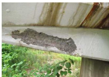
（橋脚梁部の損傷）
