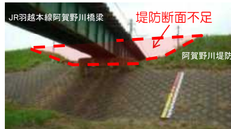
【堤防断面不足の状況】
