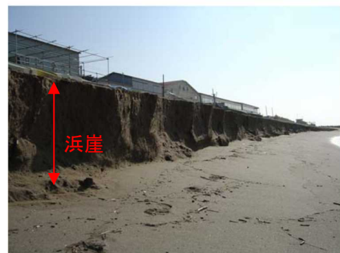
金衛町工区被災状況（平成18年9月）
