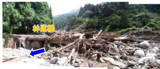
既設林道の被災状況(H23.7)
