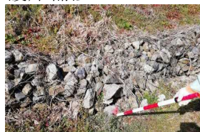
破損したふとん籠
