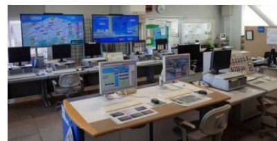
遠隔監視設備の更新
