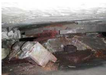
（変位制限装置の欠損）
